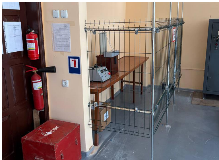
Рисунок – Спеціальне металеве огороження високовольтного випробувального апарату AV-50/70 із блоком керування
