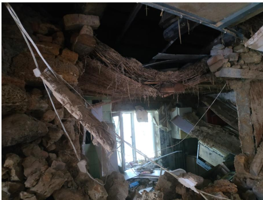
Рисунок 1 – Обвал перекриття житлового будинку в передмісті Херсону внаслідок підриву Каховської ГЕС
